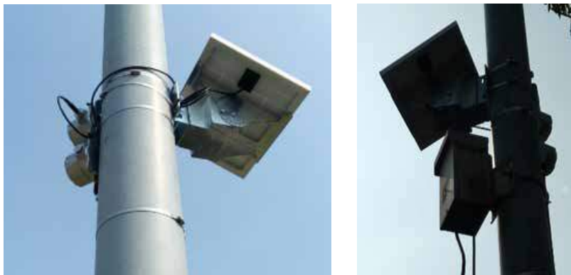
LoRa 通訊模組及太陽能板
