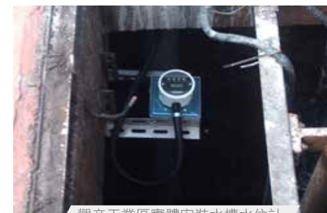
觀音工業區實體安裝水槽水位計
