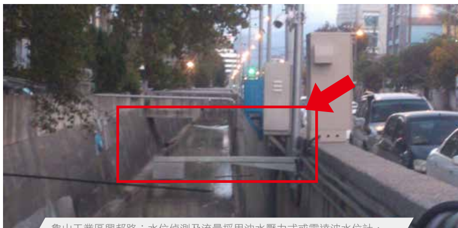
龜山工業區興邦路：水位偵測及流量採用沈水壓力式或雷達波水位計，設置於排水孔內偵測排水水位高度提供即時資訊，提供大雨防災服務。
